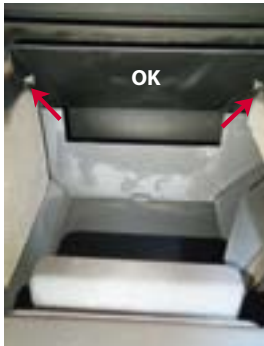
fig. 26 - Zicht op de deflector vanuit de kamer brandend
